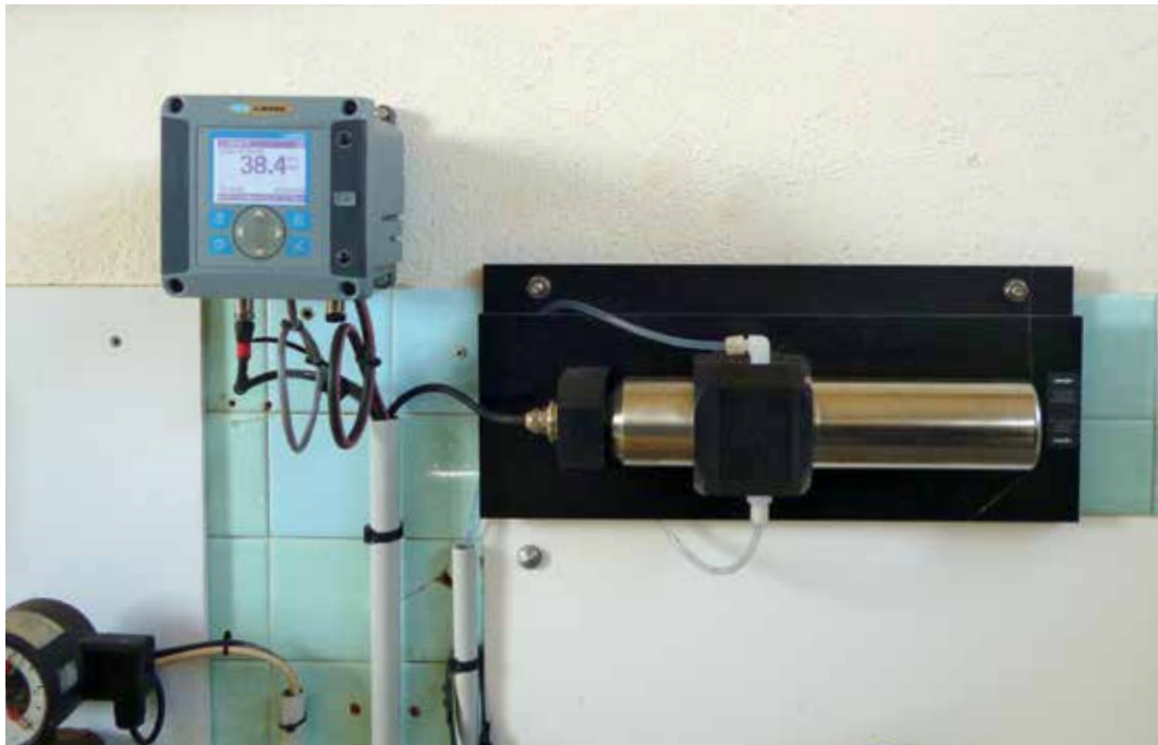
Sonde de mesure en continu des nitrates dans l'eau du captage
